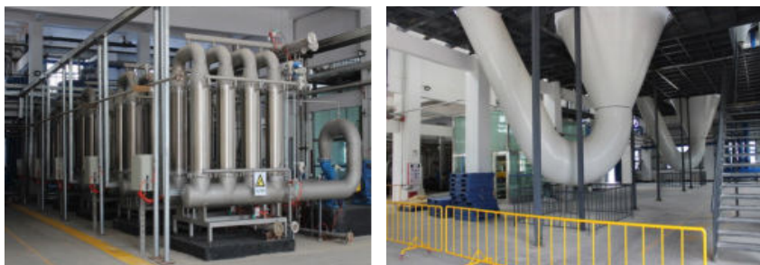
中泰化学半纤维素制取设备
